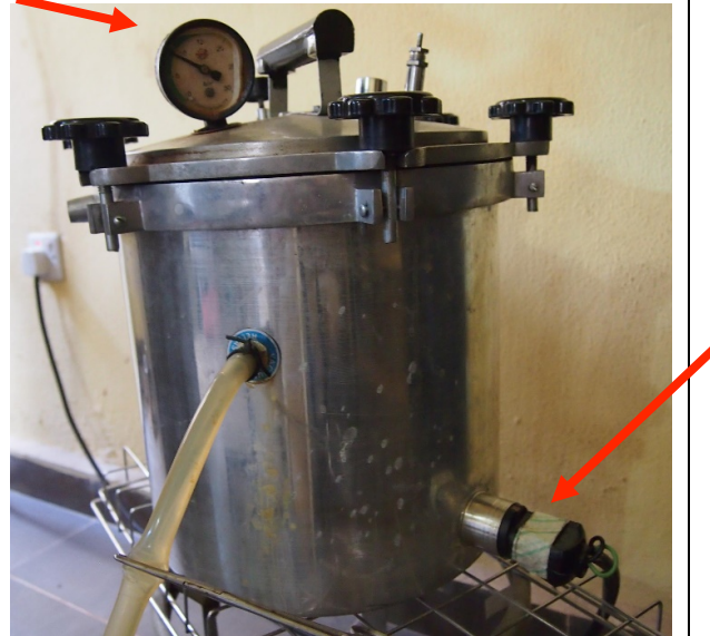
Der kleine Drucktopfsterilisator. Mit fehlendem Manometer, ein alter Schlauch, gefährlicher elektrischer Anschluss. Hier war unbedingt Wartung nötig!. 19-10-2015
